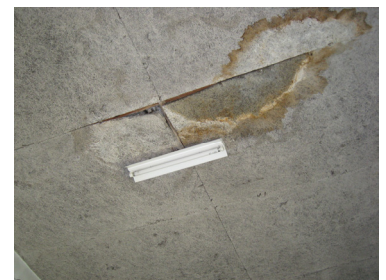
天井は雨漏り
