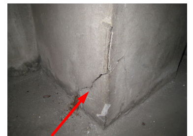
ひび割れ多数、地震に耐えられる??
