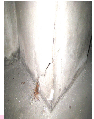
ひび割れ多数、地震に耐えられない現小倉北消防署
